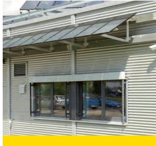
Revêtement de façade avec des modules solaires comme protection solaire du bâtiment de la société Max Fuss à Berlin
