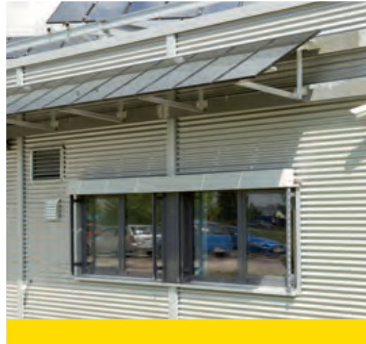
Rivestimento di facciata con moduli fotovoltaici utilizzati come protezione parasole sull'edificio della ditta Max Fuss di Berlino
